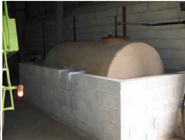
Cuve fioul en rétention
